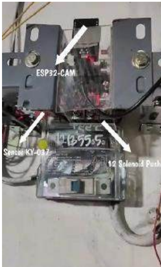
Gambar 8. Alat pada kwh meter
