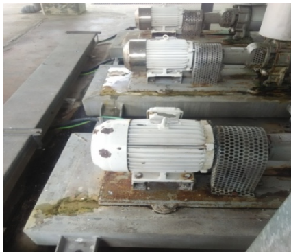
Gambar 1. Pompa chiller sentrifugal susunan seri
