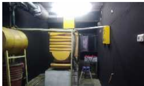
Gambar 2. Ruang Genset yang Dilapisi Peredam Styrofoam dan Karpet
