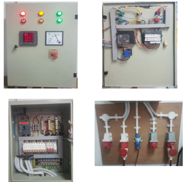
Gambar 6. Tampak Panel Listrik dan Stop Kontak
