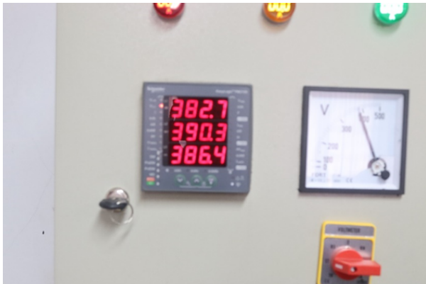
Gambar 8. Indikator Tegangan Pada Power Meter dan Panel Voltmeter Analog
