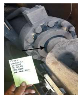
Gambar 6. Kebocoran oli hidrolik
