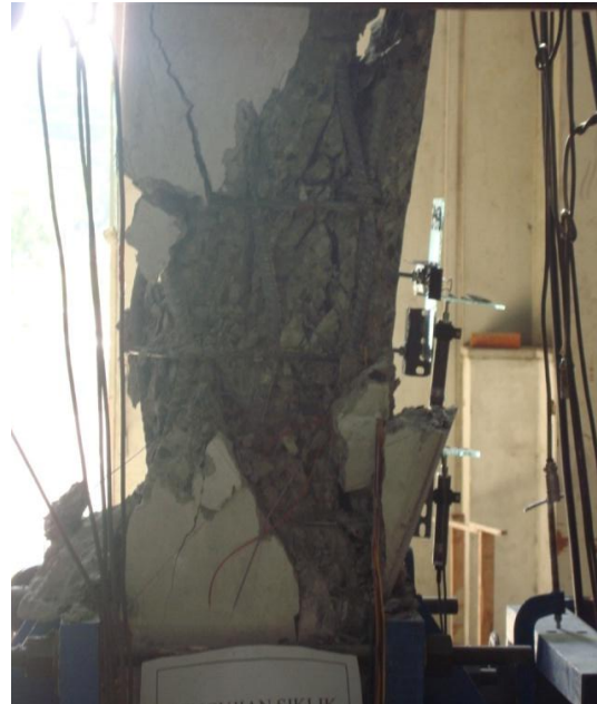
Gambar 5. Kegagalan benda uji C-1
