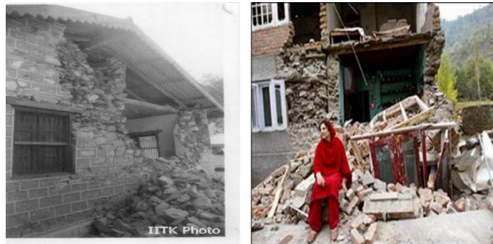
Gambar 1. Kegagalan pada rumah pasangan batu bata
