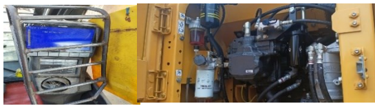
Gambar 5. Kondisi Mesin Setelah Pemeriksaan
