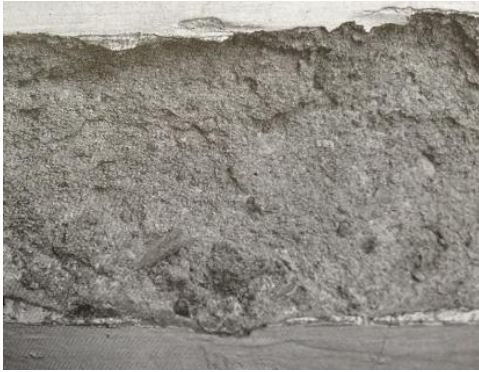
Gambar 1. Pengelupasan selimut beton
